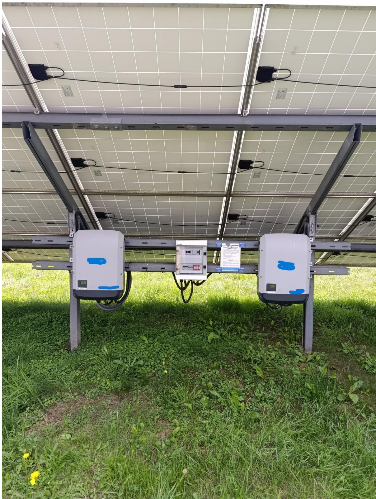
Zdjęcie nr 3- przykładowy montaż inwerterów i zabezpieczeń
