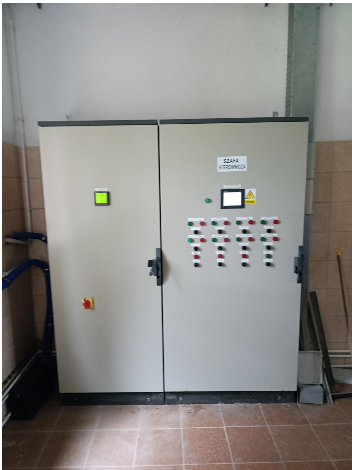
Zdjęcie nr 7- szafa sterownicza
