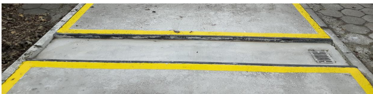
Rys. 7. Zagłębienie pod wagi przenośne typu METEOR w kształcie zamkniętej rynny ze studzienką odwadniającą.
