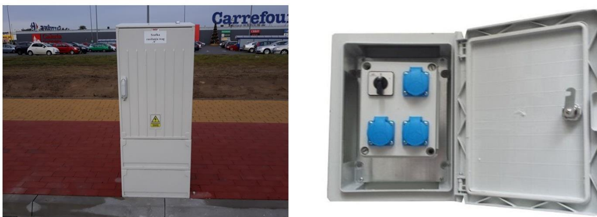
Rys. 12. Przykładowa rozdzielnica elektryczna na stanowisku kontrolnym.
