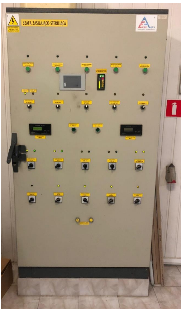
Rysunek 1 rozdzielnica – widok z zewnątrz
