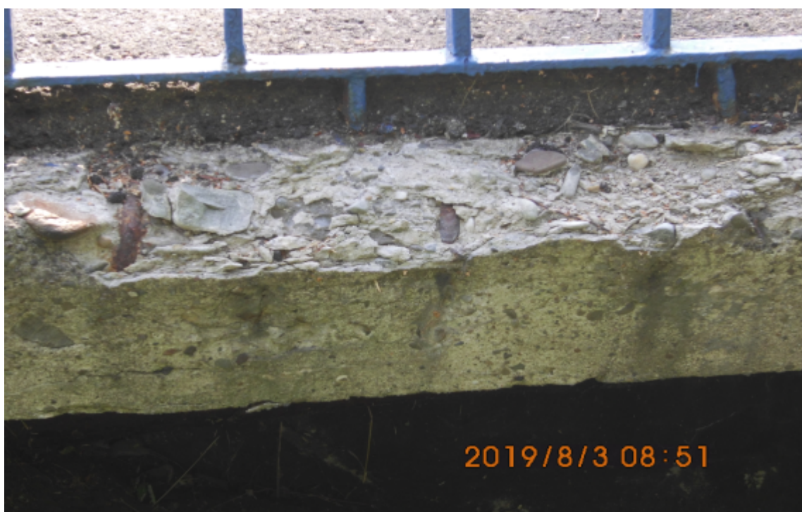
Zdjęcie 3.10 : Korozja betonu fragmentu cokołu.
