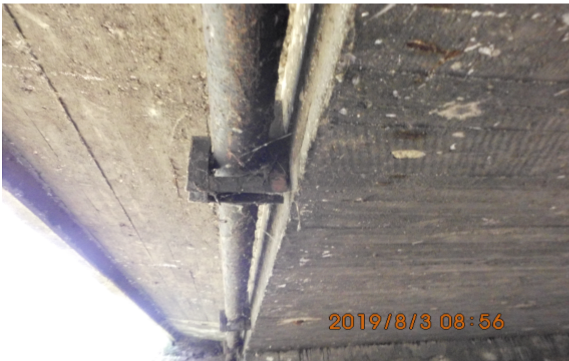
Zdjęcie 3.15 : Konieczność zabezpieczenia antykorozyjnego wsporników i osłony urządzeń obcego.
