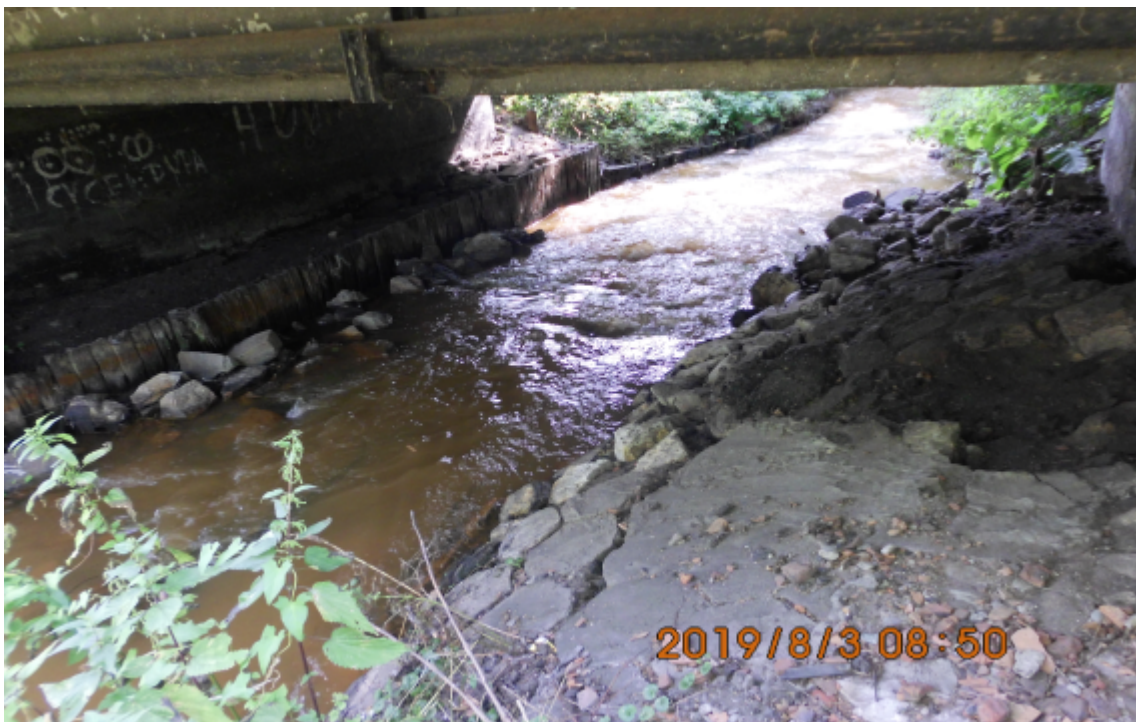
Zdjęcie 3.12 Zniszczone umocnienie skarpy w przestrzeni podmostowej
