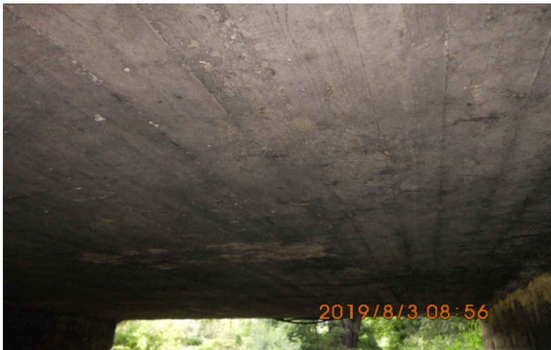
Zdjęcie 3.13 : Widok płyty od spodu mostu. Niewielkie zacieki spowodowane nieszczelnością izolacji.
