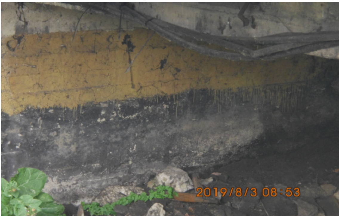
Zdjęcie 3.11 : Podwieszono zerwane kable w przestrzeni podmostowej.
