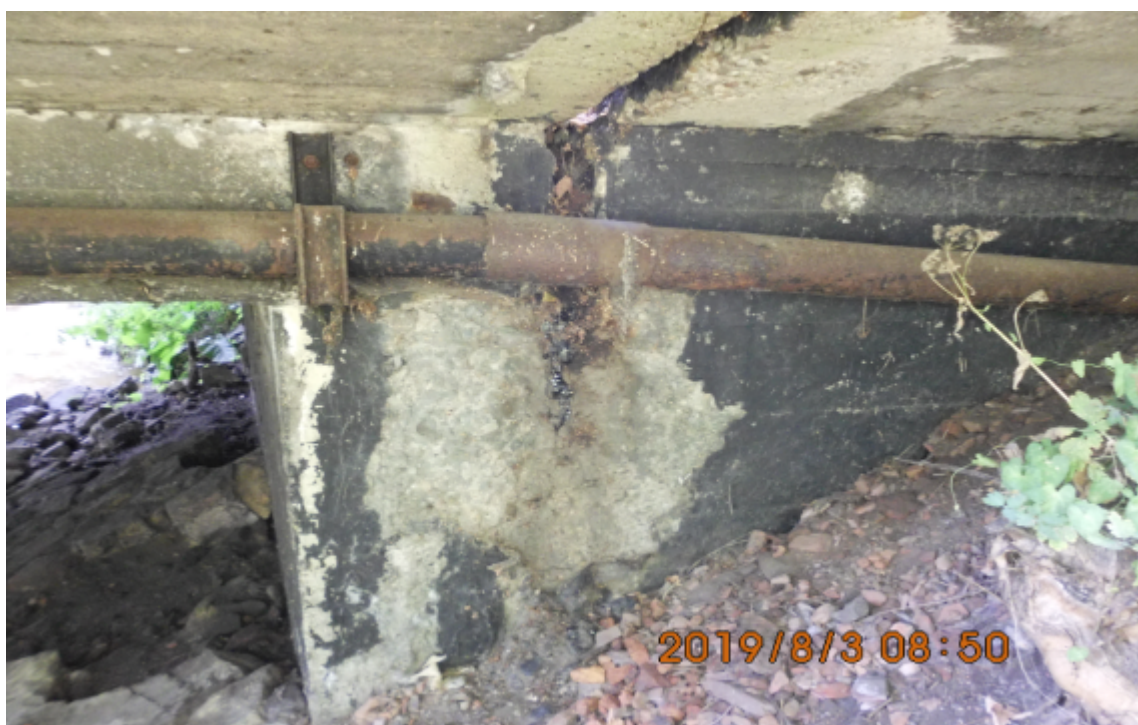
Zdjęcie 3.9 : Zacieki na przyczółku
