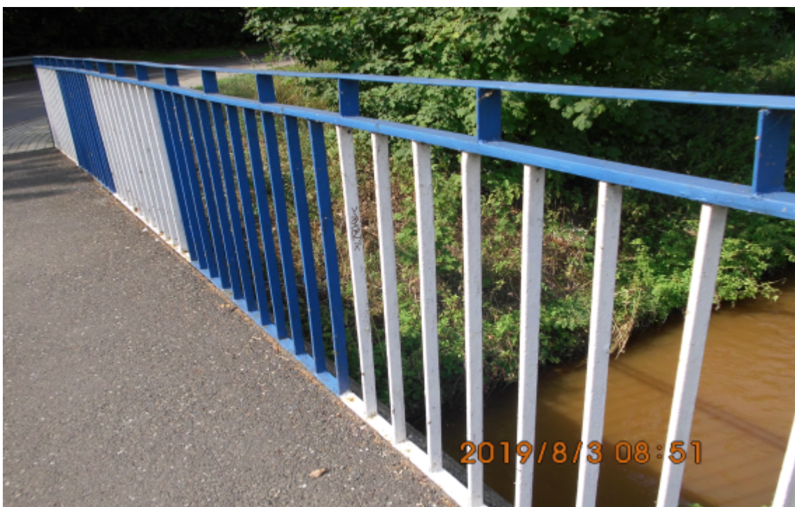
Zdjęcie 3.16 : Stan balustrady mostu
