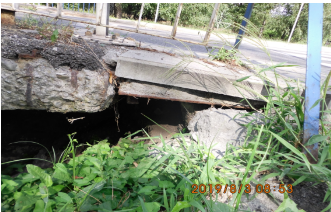
Zdjęcie nr 3.7 : Uszkodzenie skarpy i jej umocnienia nad przyczółkiem
